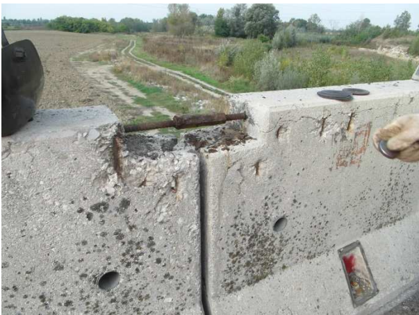
Fig. 1: Manicotti di collegamento deteriorato.
